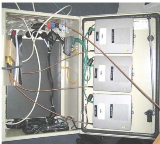
Figure 4 - Coffret radio Wi-Fi et pont hertzien avec couplage radio des points d'accès Wi-Fi
